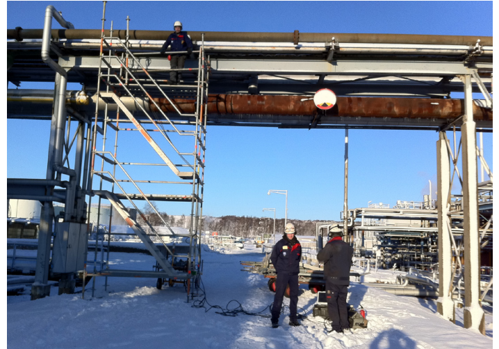
Vista general de la línea en el sitio del cruce elevado
