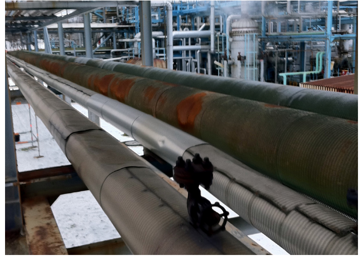
Vista general de la línea de 8" bajo aislamiento.
